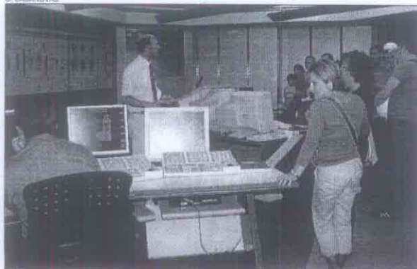
Una de les tres sales de control de la planta de Solvay a Martorell
